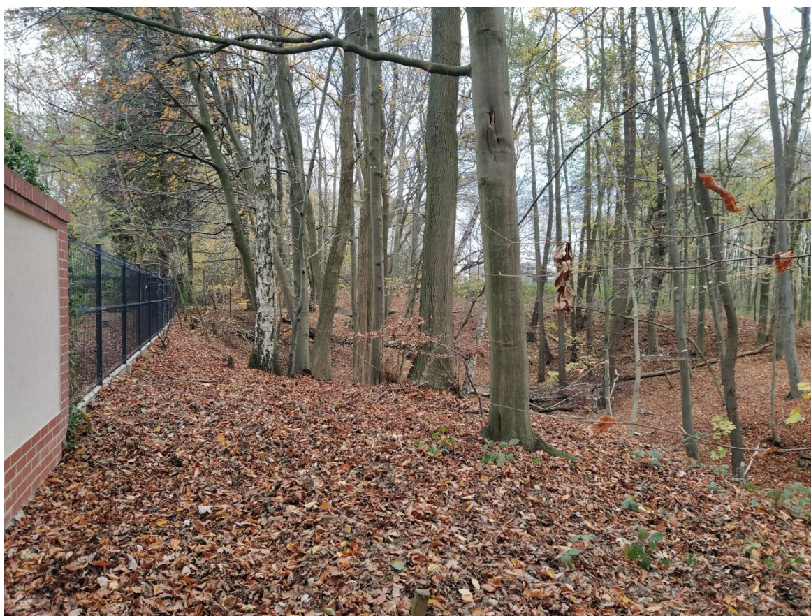
Fot. 3. Górna krawędź osuwiska dochodząca do ogrodzenia.
