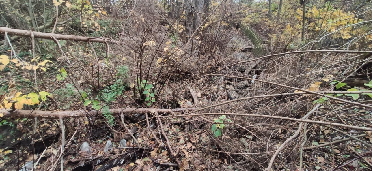
Fot. 1. Zniszczone umocnienia skarpy na jęzorze osuwiska, zaciśnięcie koryta przez materiał koluwalny.
