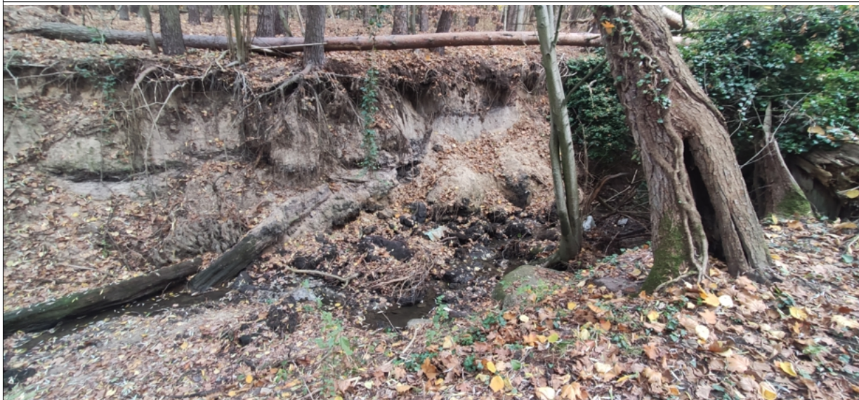
Degradacja koryta nakontakcie z osuwiskiem
