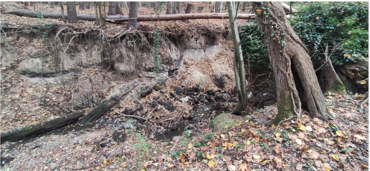
Fot. 2. Dalsza degradacja koryta przy granicy osuwiska.
